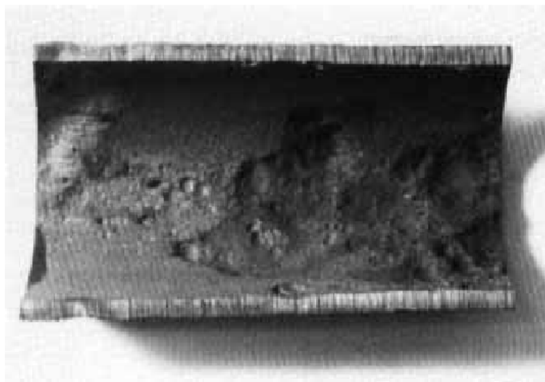
Ausgeprägte Mulden infolge Sauerstoffkorrosion in einem Rohr aus St 37 nach Entfernung der Korrosionsprodukte.
